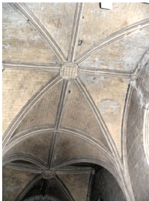
Désordre dans la voûte près du sondage n°5 Photo n°8
