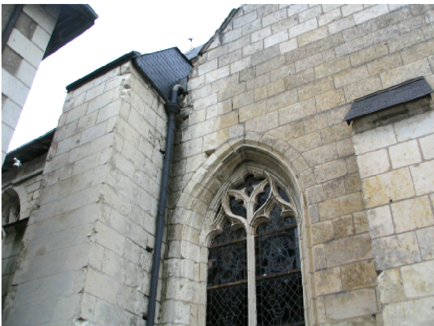
Désordre au droit du sondage n°3 Photo n°3
