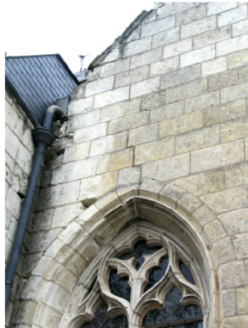
Désordre au droit du sondage n°5 Photo n°2
