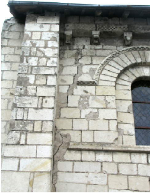
Désordre au droit du sondage n°1 Photo n°1
