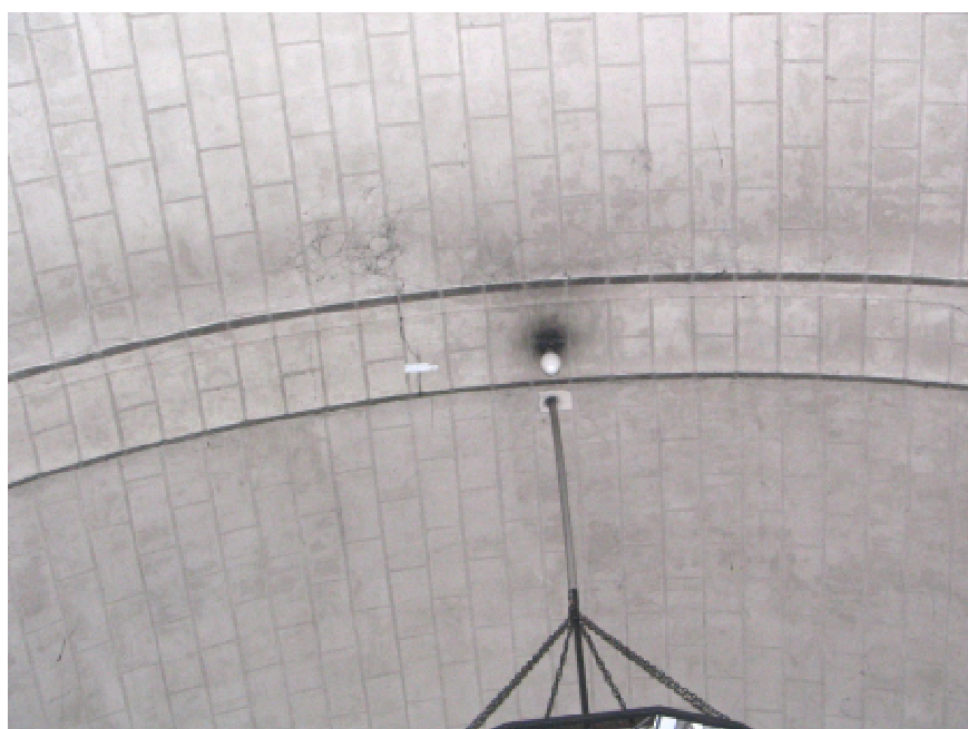
Désordre au niveau de la voûte de la nef Photo n°6
