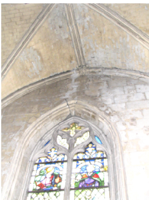
Désordre au droit du sondage n°5 Photo n°9
