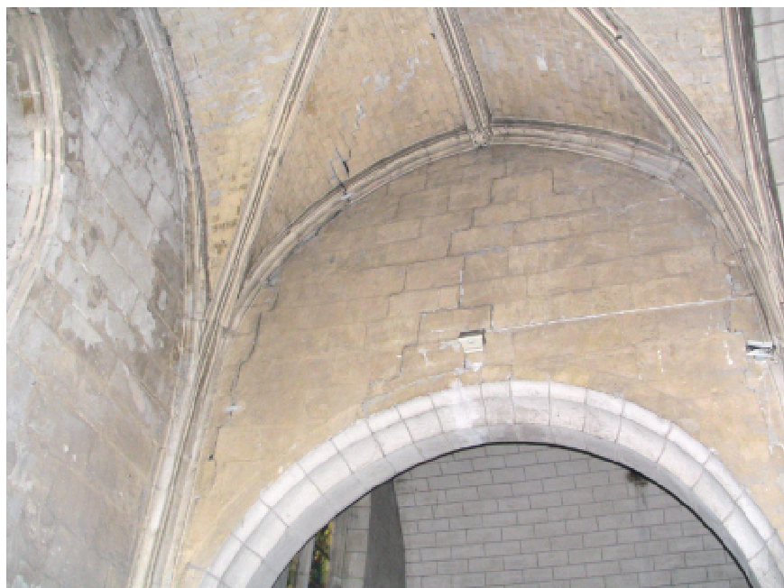
Désordre dans la voûte près du sondage n°5 Photo n°10
