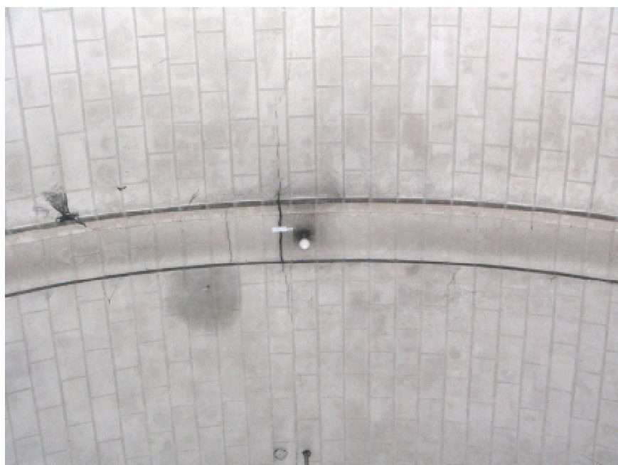
Désordre au niveau de la voûte de la nef Photo n°4
