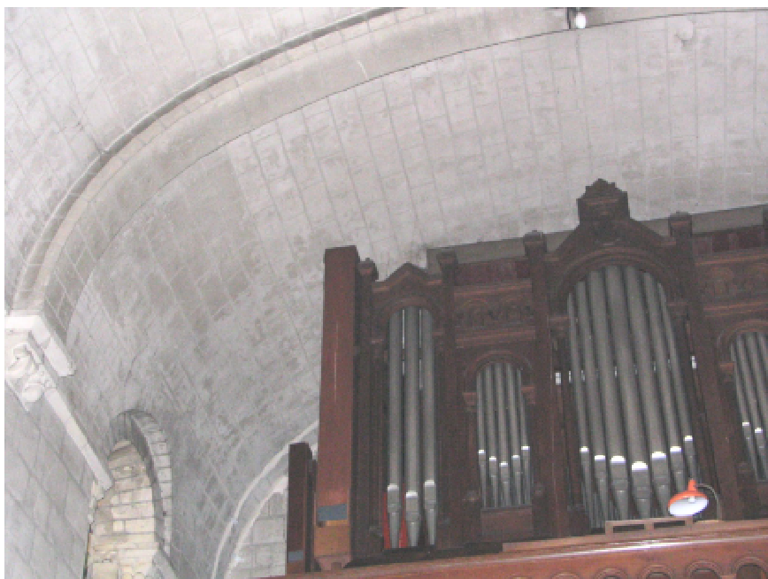
Désordre au droit du sondage n°1 Photo n°5
